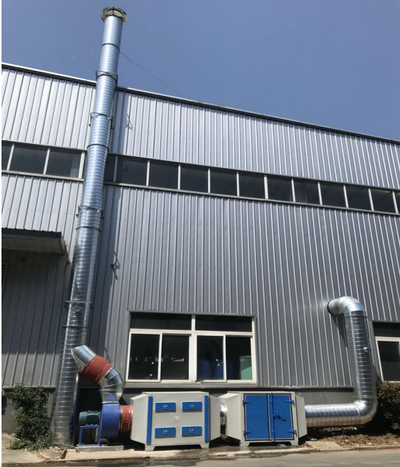
废气处理装置
