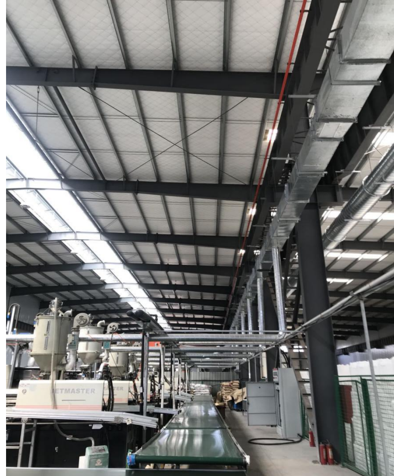
废气收集管道
